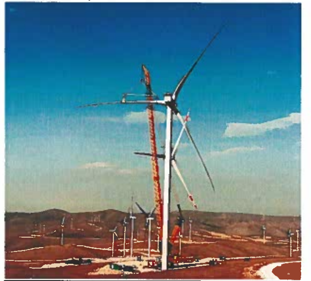
BAĞLAR RÜZGAR ENERJİ SANTRALİ PROJESİ
