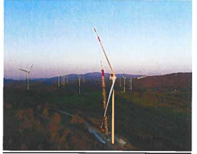
BALIKESİR ŞANLI RÜZGAR ENERJİ SANTRALİ
